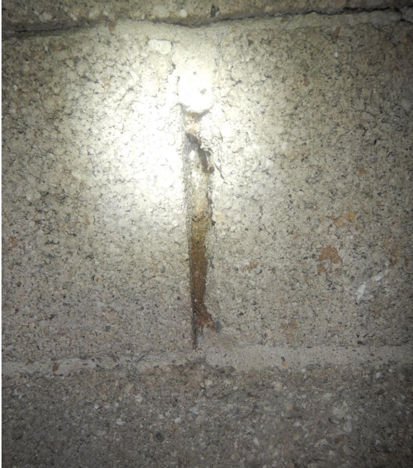
Abb. 5: Defekter Hohlblockstein mit Nistmaterial.
